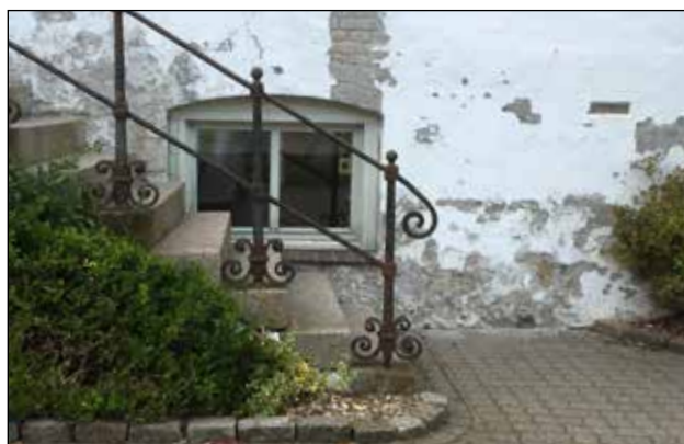
Ovenstående er eksempler på opstigende grundfugt. Ved højt vandtryk kan fugten vandre helt op til mandshøjde.
