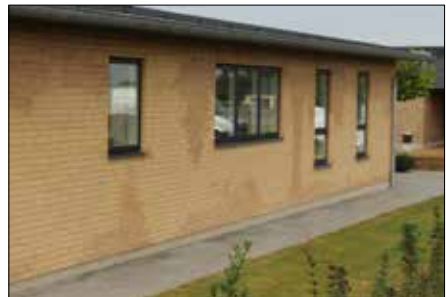
Eksempel på fugt i nybyggeri.
