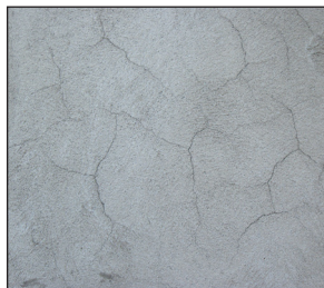
Eksempel på kosmetiske overfladerevner.
