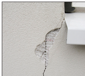
Eksempel på gennemgående revne.
