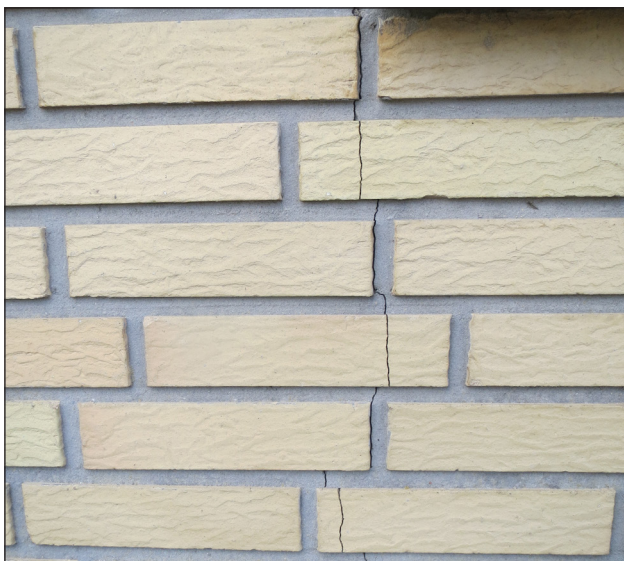
Sætningsrevner udbedres inden vandskuring.
