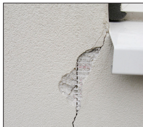
Eksempel på gennemgående revne.
