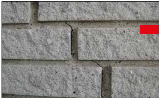
Sætningsrevner udbedres ved indmuring af rustfrit tentorstål.
