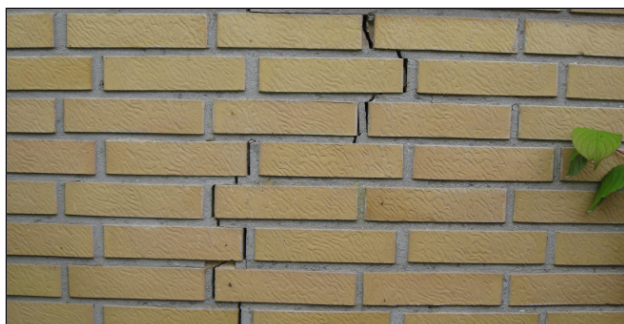
Sætningsrevner udbedres med Skalflex Multipuds og Skalflex Armérstål. Se vejledning om Skalflex Armeringssystem.
